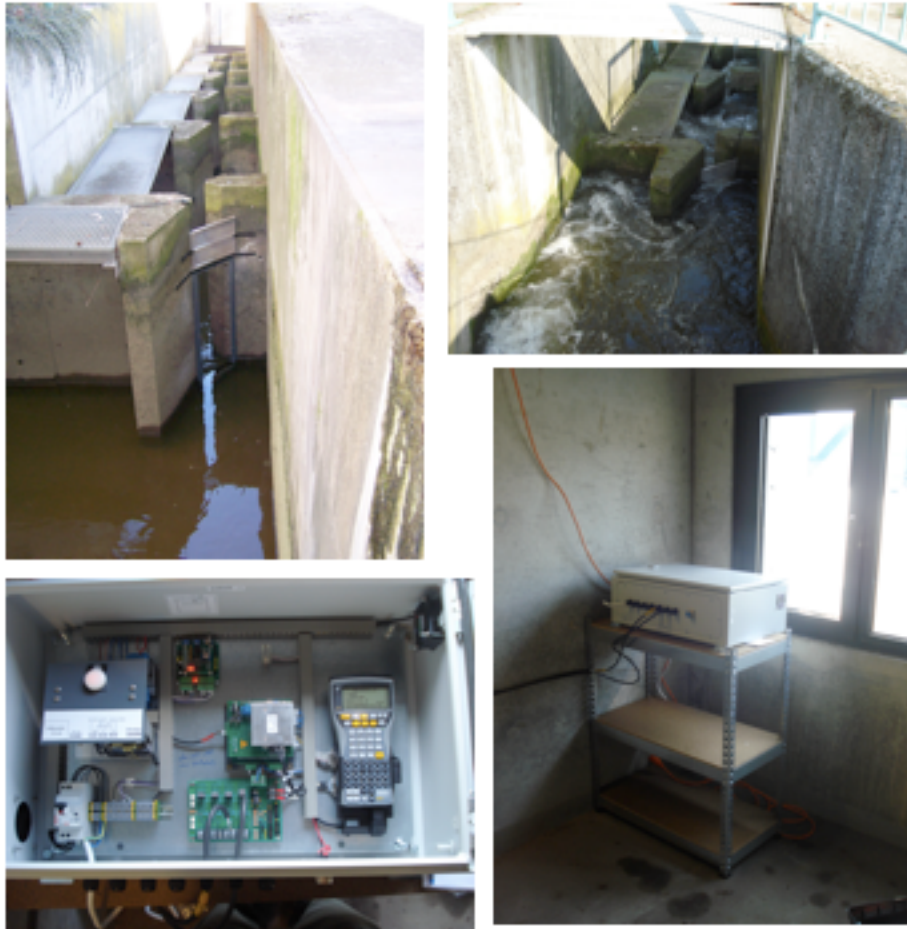
Figure 8. Détecteur RFID de installé en 2011 dans la passe à bassins du barrage d'Ivoz-Ramet sur la Meuse (km 97,1). Au-dessus : antenne de détection placée sur la fente du bassin supérieur à sec (à gauche) et sous eau (à droite). En-dessous : boîtier électronique (à gauche) abrité dans un local du barrage + centrale hydroélectrique (à droite).
