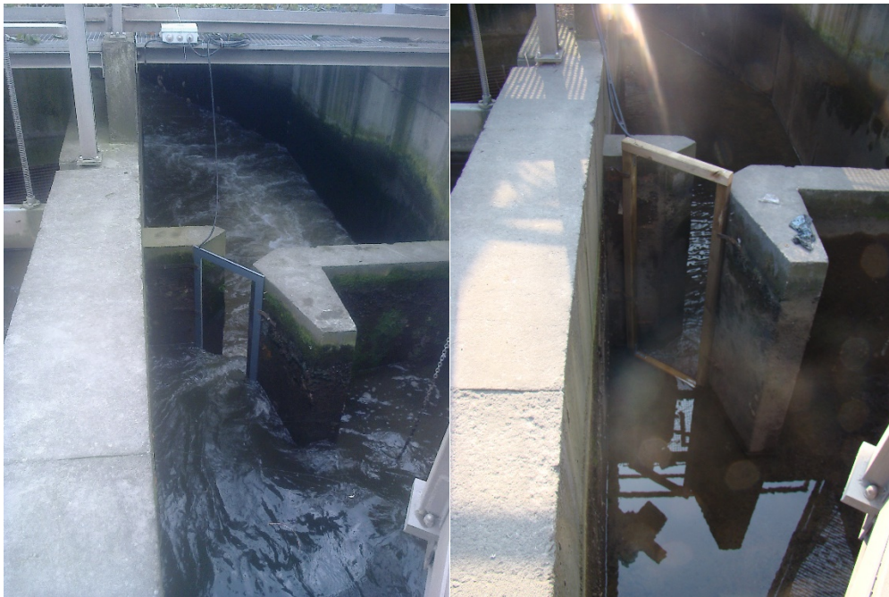
Figure 5. Partie supérieure de l'échelle à poissons à bassins du barrage de Monsin-Liège sur la Meuse (km 114,6). L'antenne de détection RFID a été placée au niveau de la dernière échancrure de la passe à poissons de Monsin. A gauche l'ancienne antenne en pvc et à droite la nouvelle antenne avec une structure en bois.
