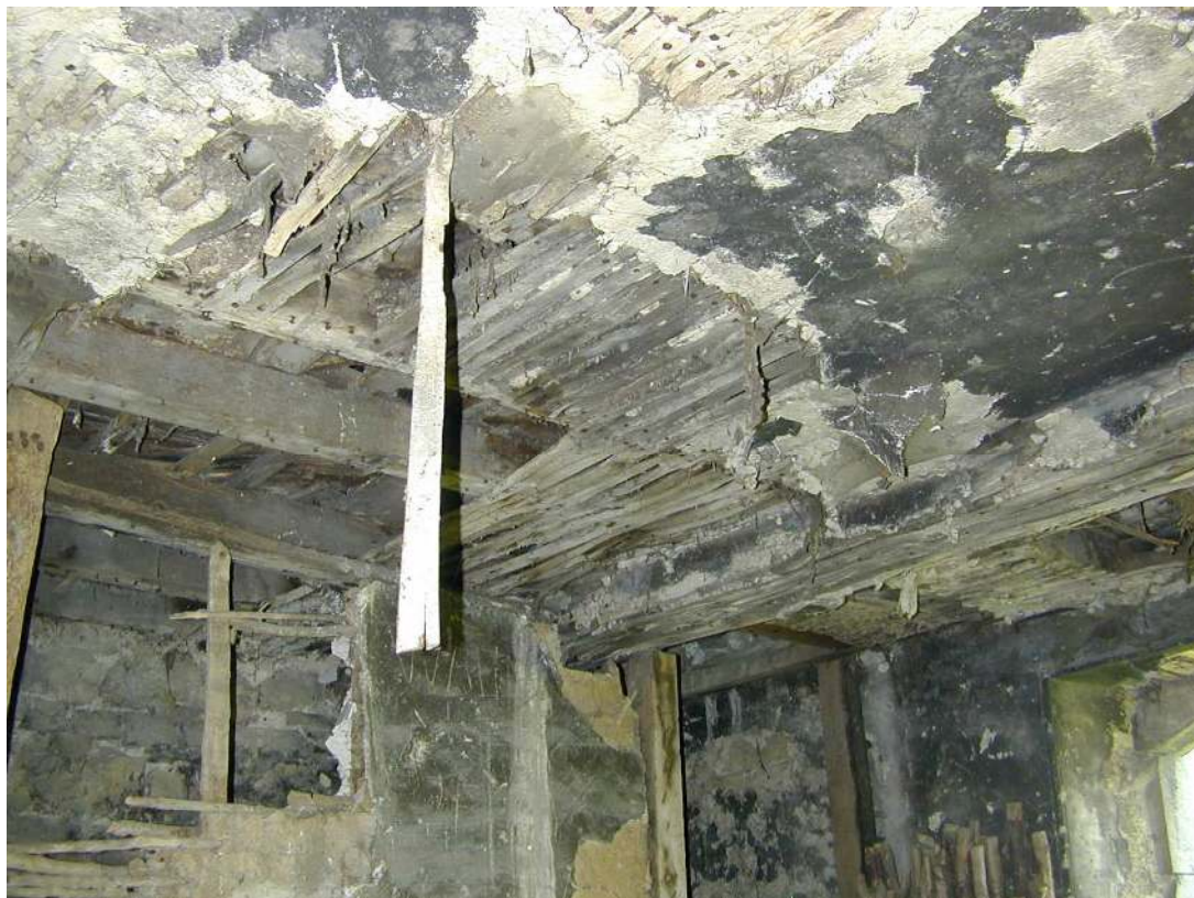
Fig. 93. 1 er étage. Plafond : solives, lattis et plafonnage. Vue vers le pan de bois. IG 2003.
