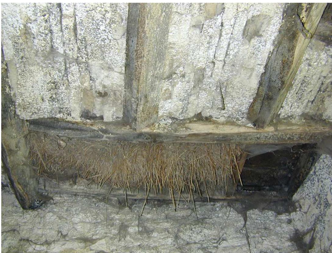
Fig. 89. Rez-de-chaussée. Plafond à entrevous en briques et solives sur pointe. Vue vers la trémie de l'escalier. IG 2002.
