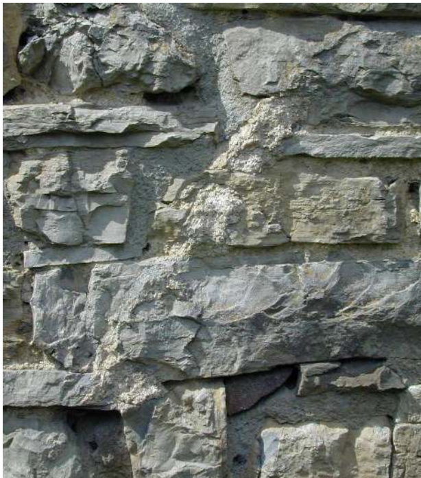
Fig. 85. Pavillon. Elévation Sud-Est. Détail du parement : moellons calcaires, joints au mortier de chaux, joints au ciment, trace d'un solin au mortier de chaux. IG 2003.
